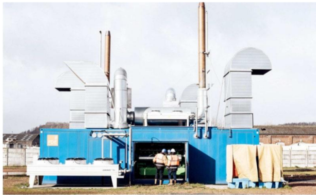
Avion (Pas-de-Calais), le 17 février. La société Gazonor, filiale de la Française de l'énergie, exploite depuis sept ans le gaz de mine qu'elle extrait de la Fosse 7, fermée en 1986.
